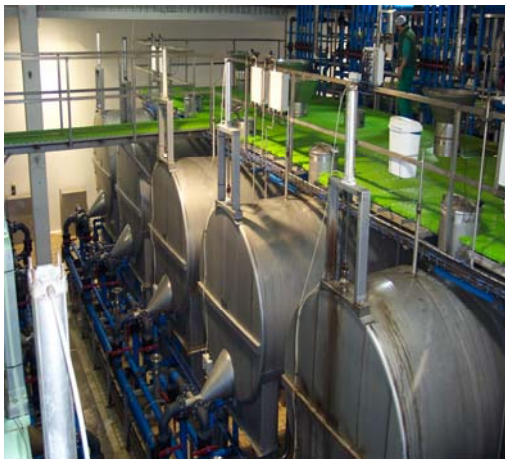
Figura 45.- Depósitos de oxidación de acero Inoxidable
