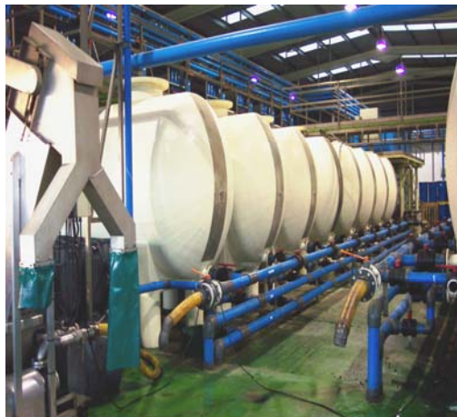
Figure 46.- Depósitos de oxidación de fibra de vidrio
