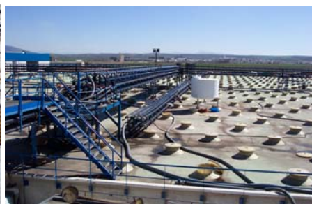
Figura 28.- Tuberías para transportar líquidos y aceitunas.
