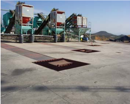
Figura 33.- Instalación para la recepción, lavado y pesado de las aceitunas
