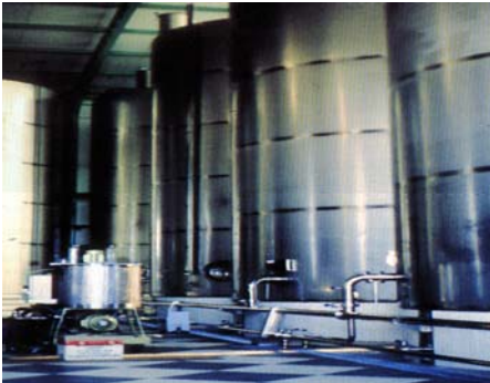
Figura 21.- Bodega con depósitos de almacenamiento de aceite
